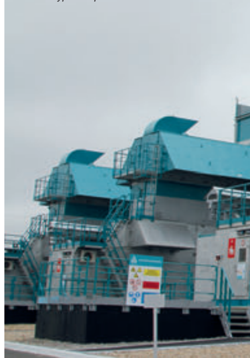
ГТУ-ТЭС на базе трех ГТЭС «Урал-6000» ЗАО «Сибур-Химпром»
